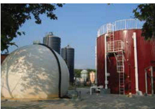
くずまき高原牧場にあるバイオガスプラント。家畜の糞尿を利用して電気と熱、肥料を供給している（岩手県葛巻町） https://www.town.kuzumaki.iwate.jp/
